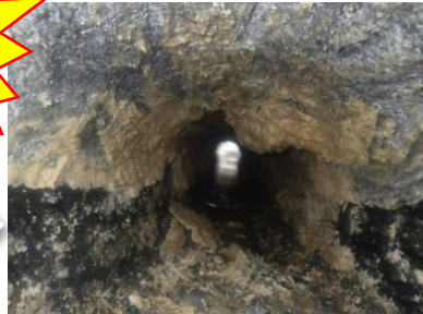
△油脂が付着した管△
