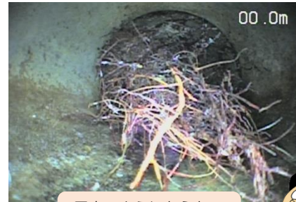
△木の根が侵入した管△
