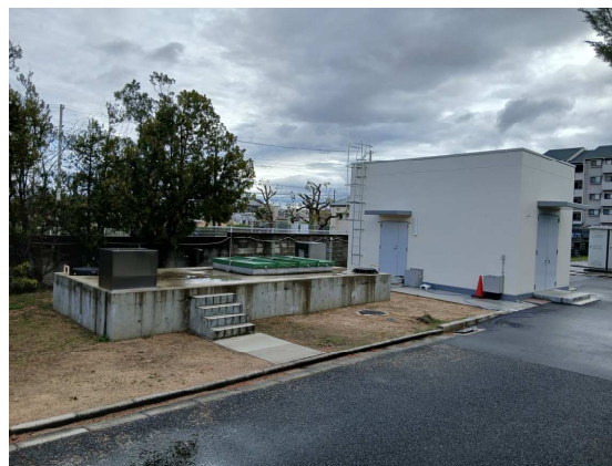
(阪神水道からの水道水受水施設（東部配水場内）)
