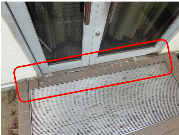
北側扉土間タイル 自治会用入口 土間タイル破損(赤枠内)
