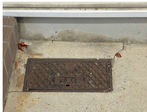
床面クラック(西側扉土間タイル横)
