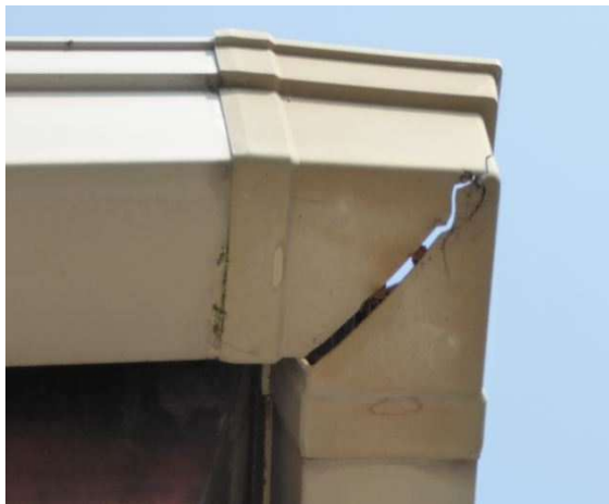
雨樋の劣化 南西角雨樋
