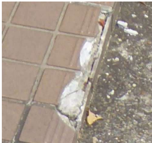
土間タイル等の劣化 西側扉土間タイル
