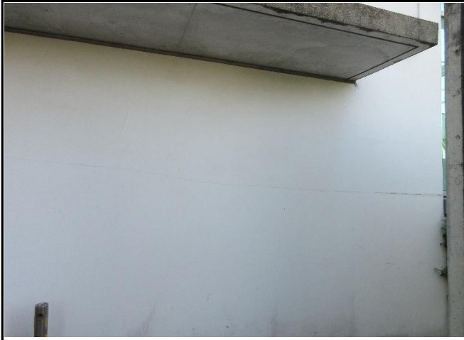
⑦外壁クラック
