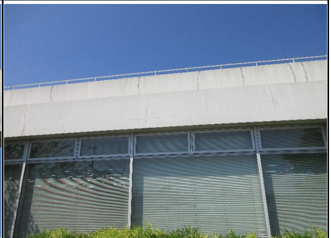
② 外壁クラック
