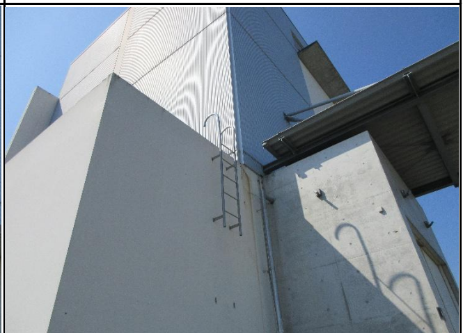
⑩外壁クラック、錆汁及び爆裂
