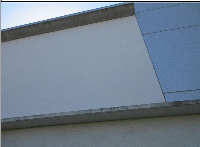
⑨外壁クラック
