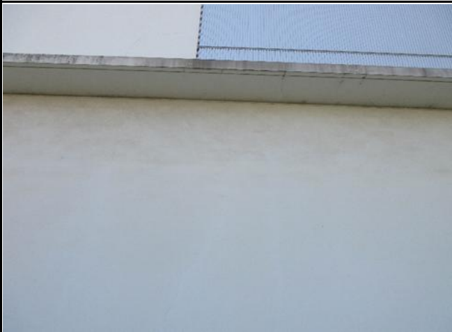
㉑庇裏クラック
