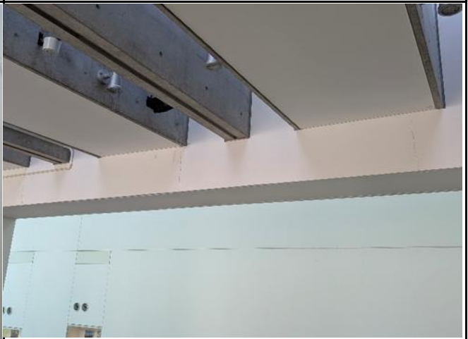
②⑧ アトリウムロビー梁クラック
