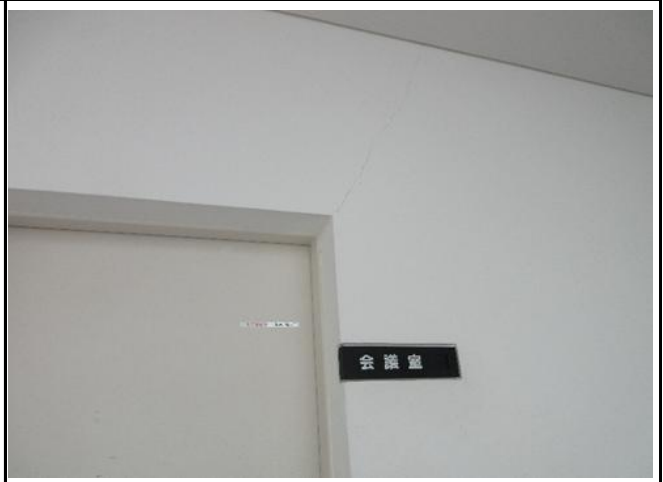
②⑥ 会議室出入口内壁クラック
