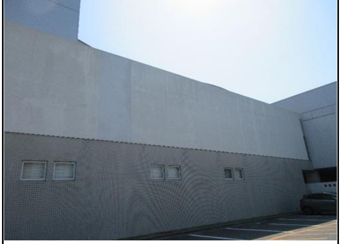
⑳外壁クラック
