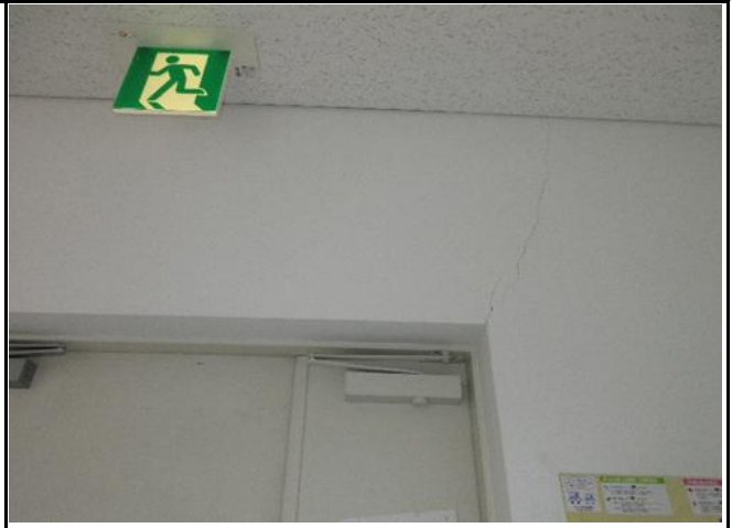
⑭図書館作業室内壁クラック
