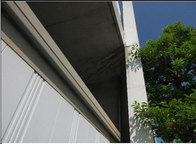
⑬天井スラブクラック、エフロ発生
