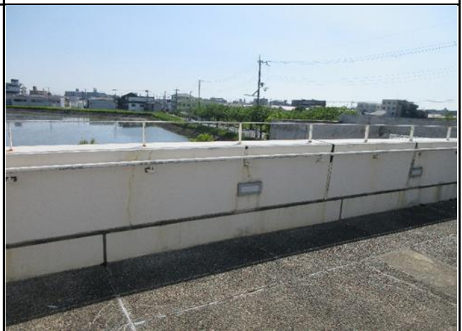
⑱手摺塗装剥がれ・腰壁クラック
