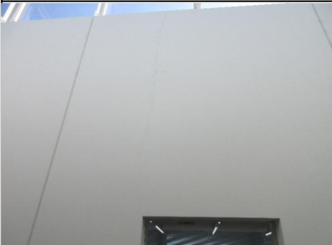
②⑦ 図書館吹抜け内壁クラック
