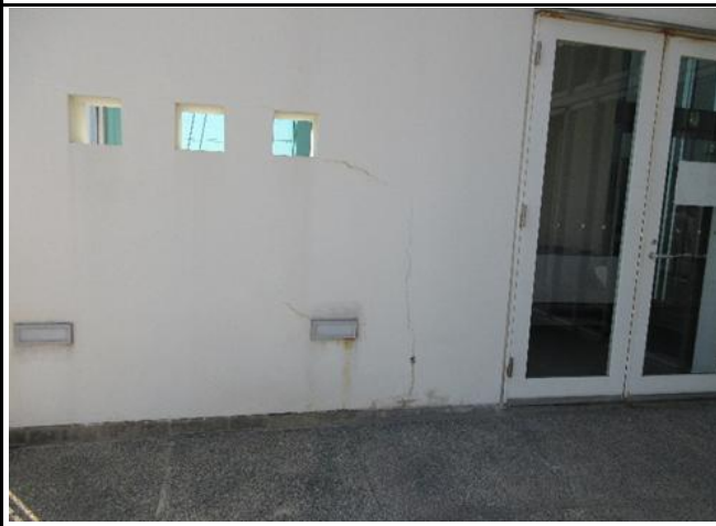
㉓外壁クラック
