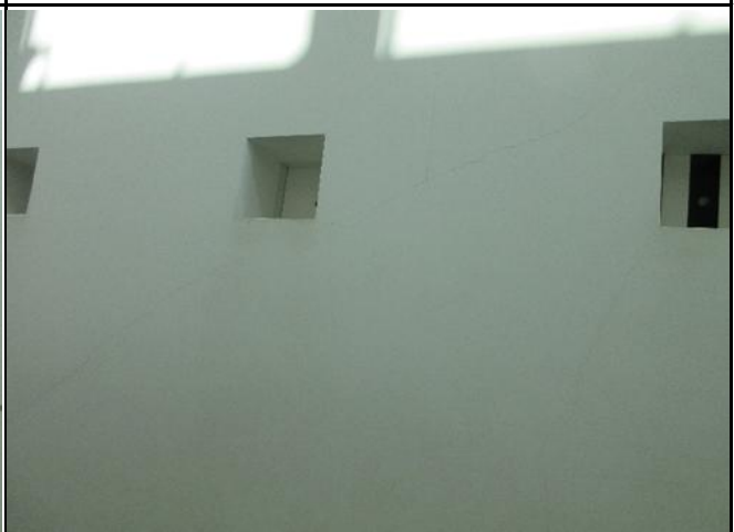
③⑩ スロープ内壁クラック
