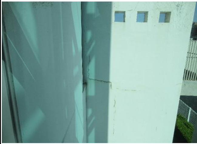
⑱外壁クラック
