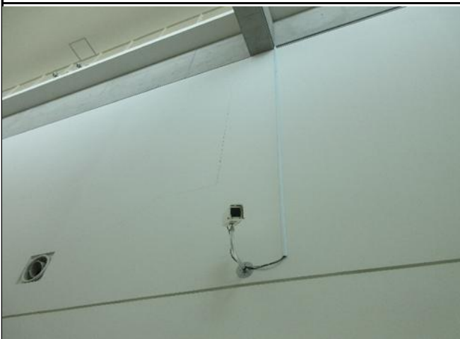
②⑨ スロープ内壁クラック
