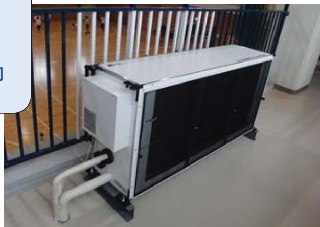
エリア式空調機（錦城中学校）
