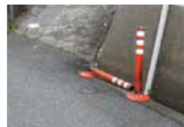
ポストコーンの破損
