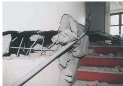
内塔の破損(13～14階)
