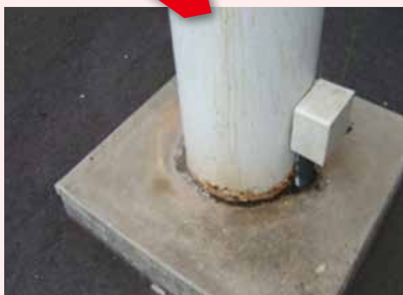
ポールの根元にサビが発生
