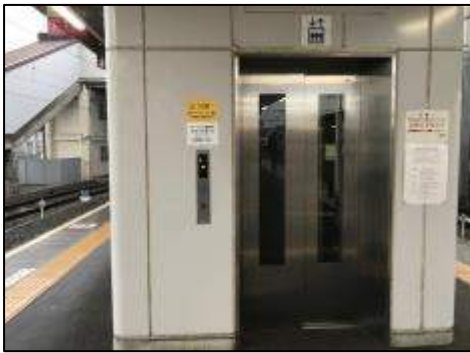
駅構内のエレベーター
