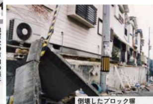
倒壊したブロック塀
