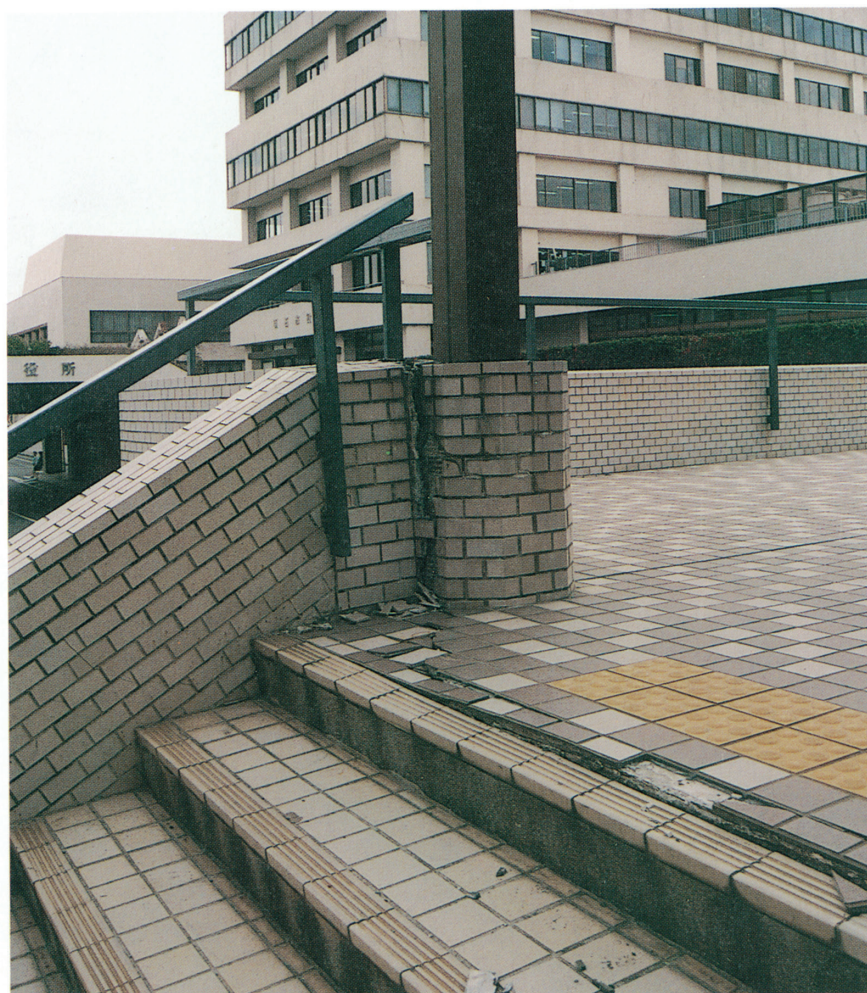
今回の震災では、市役所も渡り廊下などに被害を受けた
