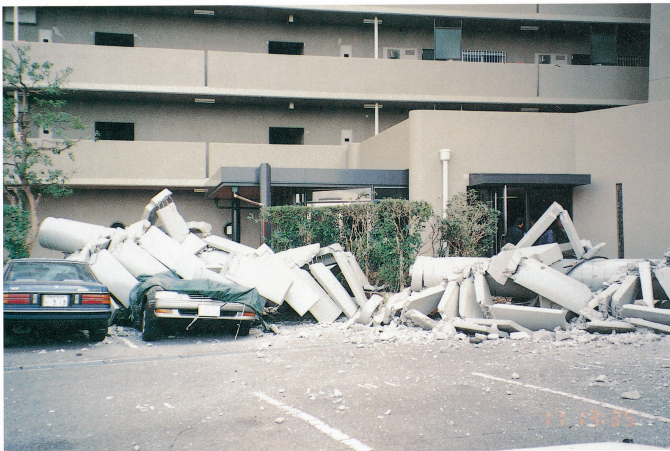
▲マンションの外部階段も崩壊した(中崎2丁目)
