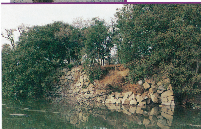
◀石垣が崩壊し、樹木が倒壊(明石公園)
