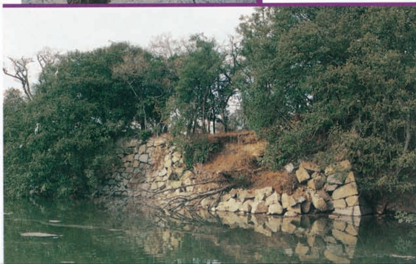
◀石垣が崩壊し、樹木が倒壊(明石公園)
