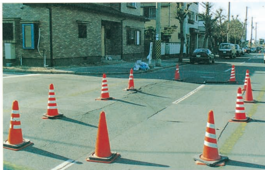
大きく陥没した道路(岬町)
