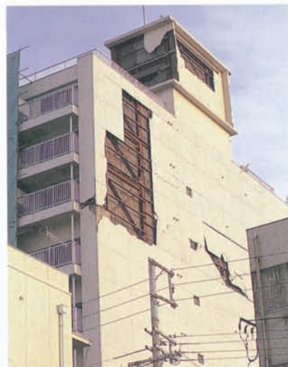
▲外壁が大きく崩れ落ちたマンション(樽屋町)
