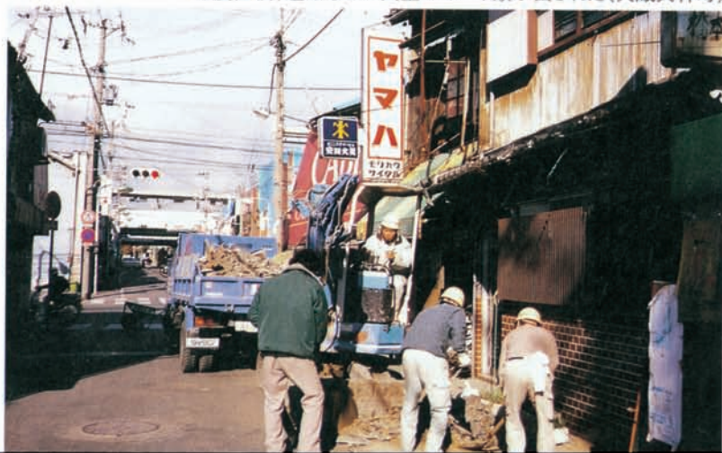
地震直後、道路などに大量のガレキ類が出された(大蔵天神町)
