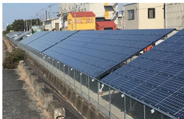
南二見人工島の太陽光発電設備
