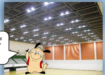
明石中央体育会館 照明LED化
