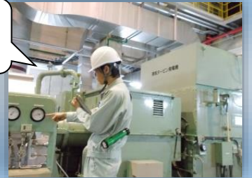
明石クリーンセンター タービン発電機
