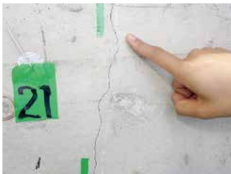
火葬場棟の壁のひび割れ
